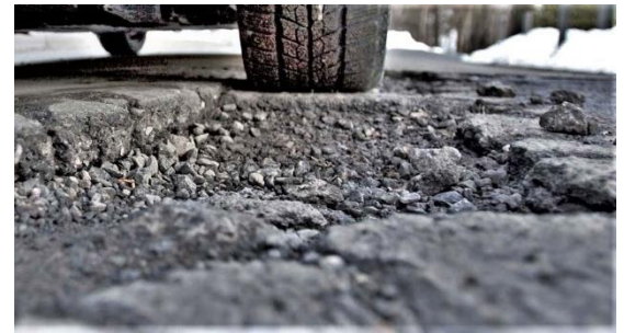
Charge excessive de choc causé par des nids-de-poule ou un impact sur le trottoir
